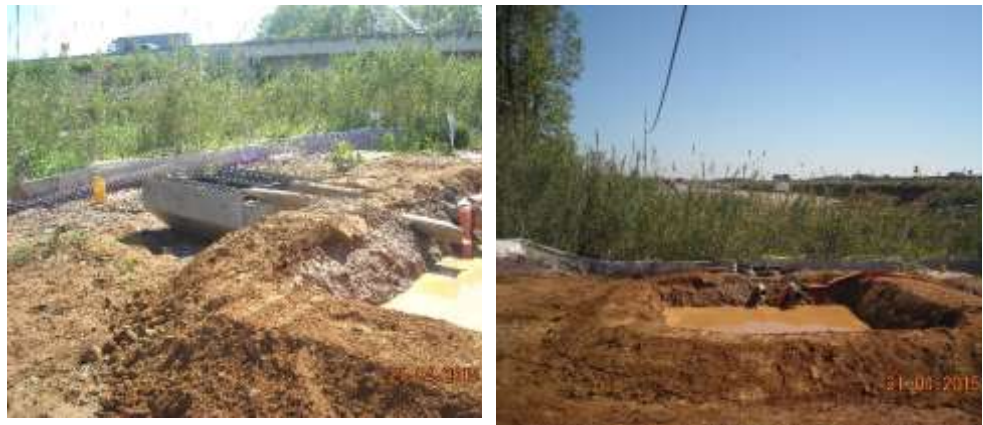
Bassin de décantation de type rustique
